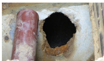
Typisches Schadensbild: Ausgebrochene und nicht maßhaltige Öffnungen.
