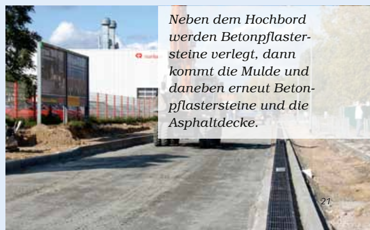
Die Kunststoffmulde nimmt das Niederschlagswasser der öffentlichen Verkehrsflächen auf und gibt es in unbedenklichem Zustand ans Grundwasser ab.
