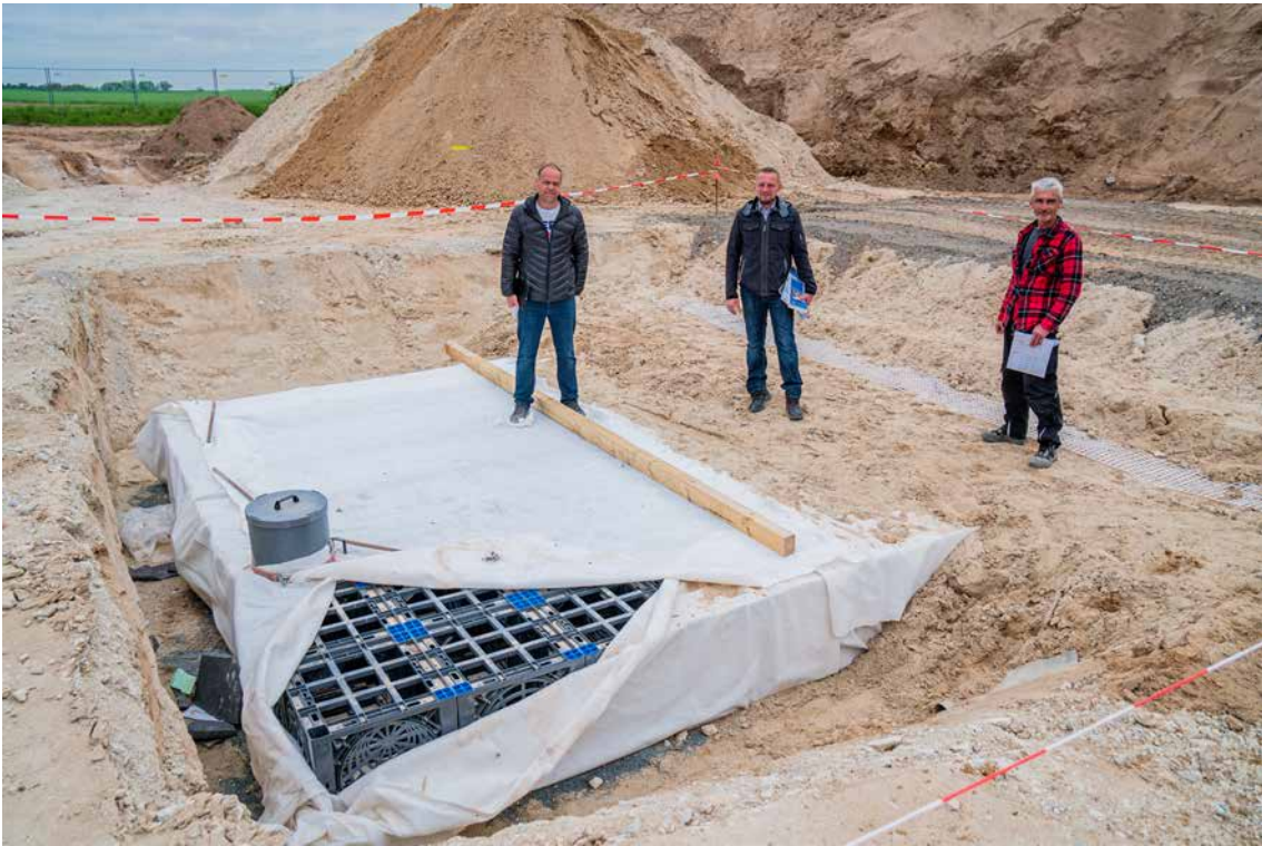
Baubesprechung vor Ort (v.l.n.r.): Bauleiter Andreas Nutz von KOLB Garten- und Landschaftsbau, Funke-Fachberater Ralf Weber und Polier Joachim Schmidt von KOLB Garten- und Landschaftsbau.
